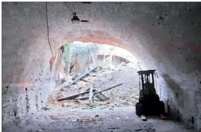
Pohled sklepem směrem k propadu klenutého stropu
