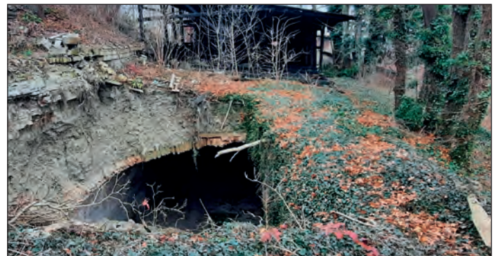
Propadlý strop sklepa zvenku
