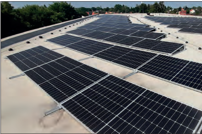
Fotovoltaika na 1.stupni
